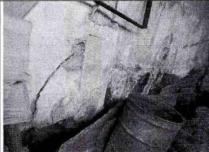
Foto 8. Muro divisorio deteriorado agrietado por la falta de mantenimiento, deficiencias constructivas de la vivienda ubicada en la Cra. 15 Bis E 57-24 Sur construido en forma de terraza sobre un talud de corte, el cual carece de bases de y manejo de las aguas subsuperficial.
