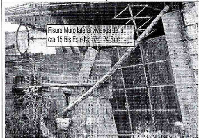
Foto 6. Patio interior vivienda ubicada en la Cra. 15 Bis E 57-24 al fondo se observa muro lateral fisurado construcciones antiguas de más de 50 años.
