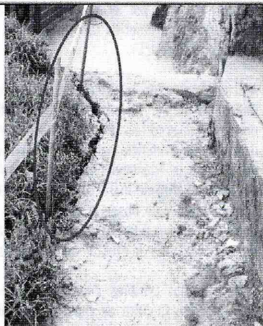
Fotografía No. 4. Grieta de tracción con abertura entre 3 a 4 cm sobre el sendero peatonal de la Calle 68G Bis Sur, ubicado en la parte alta del talud.
