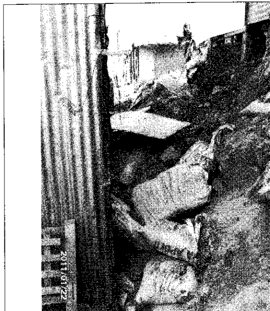
Foto 5. Predio B (izquierda) y predio de la Calle 79 Sur No. 14A-83 (derecha). Ambas viviendas sufrieron afectaciones importantes a nivel de cubiertas. Fecha: 22 de Enero de 2011.
