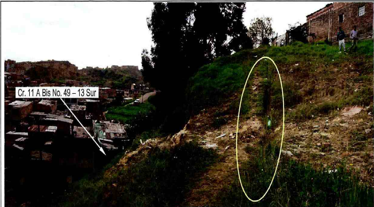
Fotografía 3. Vista general del costado sur del talud. Se indica la cuña de tracción que define una cuña potencialmente inestable de volumen superior a 200 m 3 .
