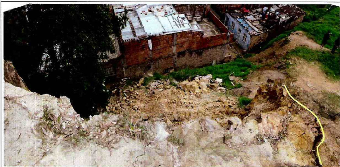
Fotografía 2. Vista general desde la parte alta del talud. Se observa el costado norte de la grieta de tracción que define el bloque inestable, y las viviendas que resultaría afectadas ante un eventual colapso súbito de la misma.
