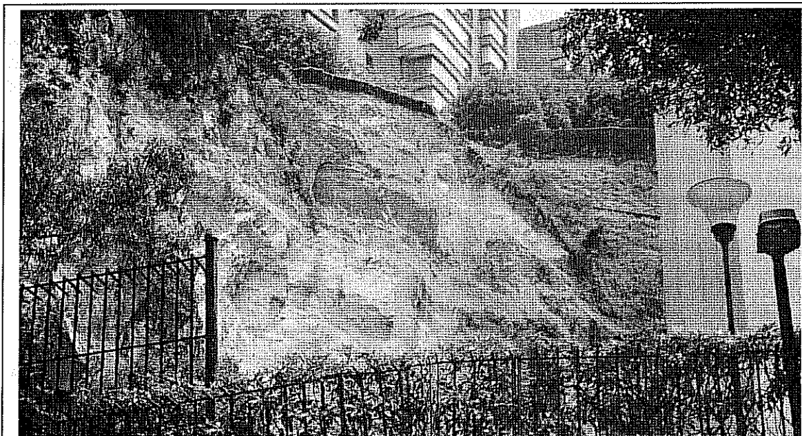
Fotografía 1. Vista general del talud existente hacia la parte posterior del predio de la Cra. 4 No. 87 A – 60, afectado por desprendimiento de materiales en la parte alta.
