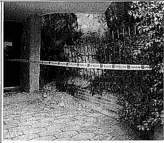
Fotografía 7. Vista general del proceso de inestabilidad del talud cercano a la portería de la Torre A del Edificio Buenavista del Refugio que compromete el ingreso seguro al edificio.
