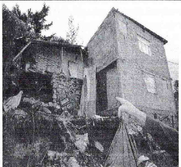
Foto 2. Viviendas del predio de la Carrera 4 Este No. 163A-64 Int. 1. En la parte baja, talud de corte inestabilizado durante las obras realizadas en el predio de la Carrera 4 Este No. 163A-68.
