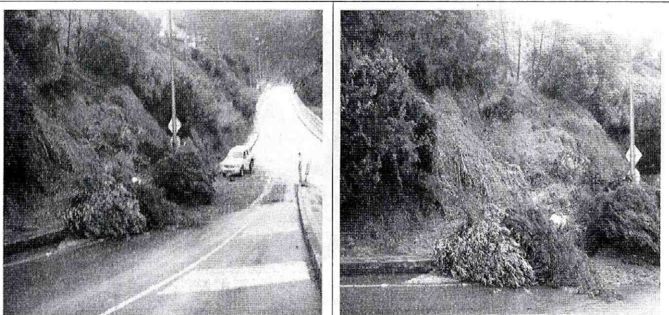
Fotos 1 y 2. Vista del proceso de remoción en masa identificado el cual movillizo aproximadamente 15 m 3 que se depositaron sobre la bifurcación que da acceso a la Avenida Circunvalar y al interconector de la calle 63 desde el oriente
