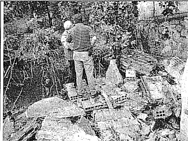
Fotos 3. Escombros resultantes del colapso del muro de cerramiento del costado norte del predio de la Calle 110B No. 0-28.
