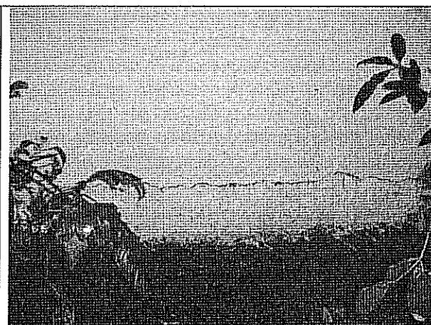
Foto 6. Grieta de tendencia horizontal en la base del muro de lindero entre los predios de la Calle 110B No. 0-28 y de la Calle 110B No. 0-40.
