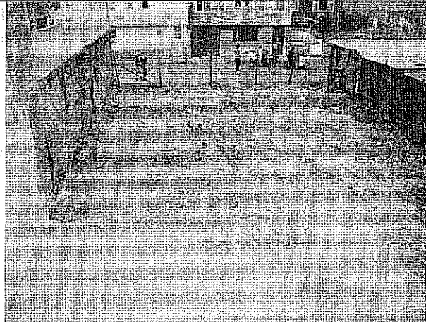
Foto 4. Vista parcial del predio de la Carrera 75F No. 57N-43 Sur, en el que se desarrollaron actividades de demolición en los días previos a la atención del evento.
