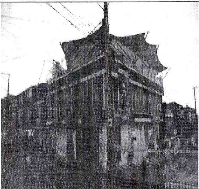
Foto 4. Vista exterior de la estructura emplazada en el predio de la Calle 76B Sur No. 0-04.
