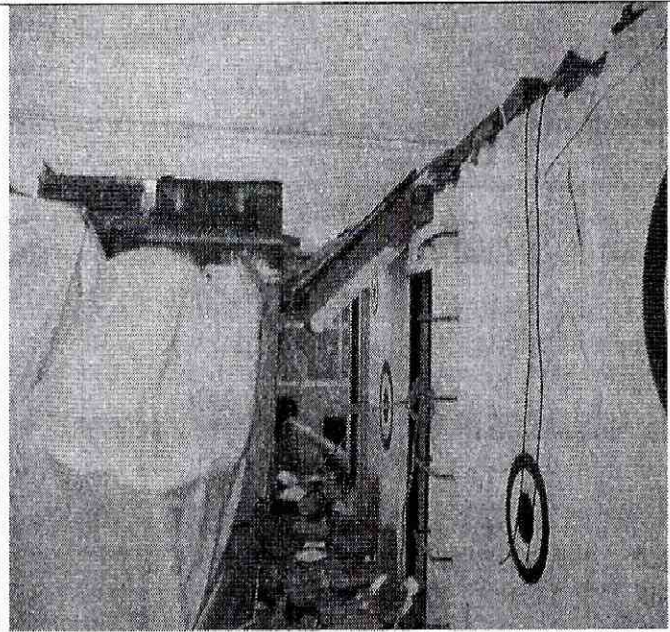
Foto 2. Evidencia del colapso de la cubierta y el colapso parcial del muro de cerramiento perimetral del costado occidental del tercer nivel de la estructura evaluada.
