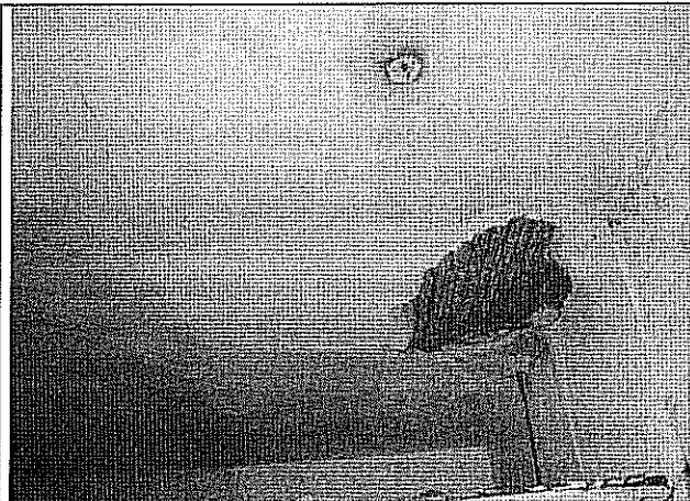
Foto 2. Sector de cielorraso afectado por agrietamiento y desprendimiento de fragmentos de mortero.
