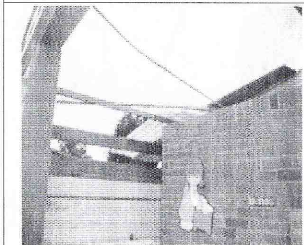
Fotografía 8. Vista de la zona de Baños infantiles del Colegio San Ángelo donde se perdió la funcionalidad del sistema de cubierta en tejas plásticas
