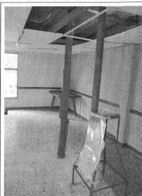
Foto 4. vista del apuntalamiento generado como medida de mitigación temporal a la situación de riesgo.
