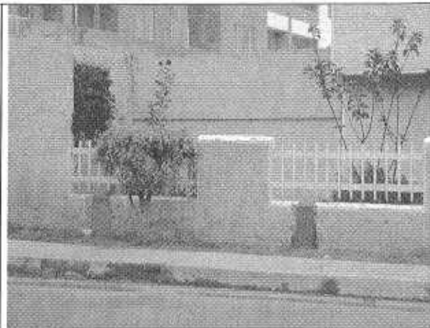
Foto 10. Colocación de columnetas de concreto en el muro de cerramiento (tomada el 23/09/2010).
