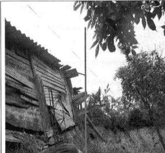
Fotografía 9. Se evidencia la pérdida de verticalidad general de la vivienda y evidencia el riesgo de colapso de la misma en el corto plazo de no realizarse labores tendientes al mejoramiento de la calidad de la vivienda. Mayo 15 de 2010.
