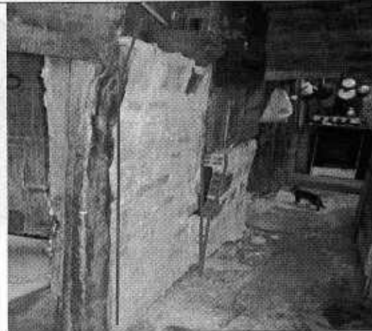
Fotografía 2. Interior de la vivienda primer nivel, se evidencia la pérdida de verticalidad de los muros divisorios los cuales no cuentan con elementos de confinamiento tipo vigas y columnas y se observa carencia de material de pega entre los elementos que lo conforman. Mayo 7 de 2009.
