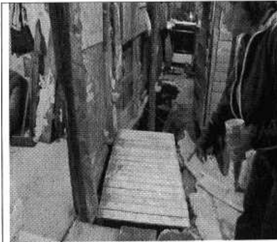
Fotografía 3. Se observa que se han realizado labores de demolición de los muros divisorios en mampostería, actividades que posiblemente generaron el desconfinamiento del relleno de cimentación causando el colapso del muro por pérdida del suelo de soporte. Noviembre 19 de 2009
