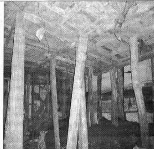
Fotografía 6. Se observan nuevos elementos de apuntalamiento artesanal de la estructura en madera que conforma el entrepiso del nivel superior de la vivienda. Se evidencia el material desprendido del terreno de cimentación del costado oriental de la vivienda, el cual se deposita en el interior del sótano. Abril 6 de 2010
