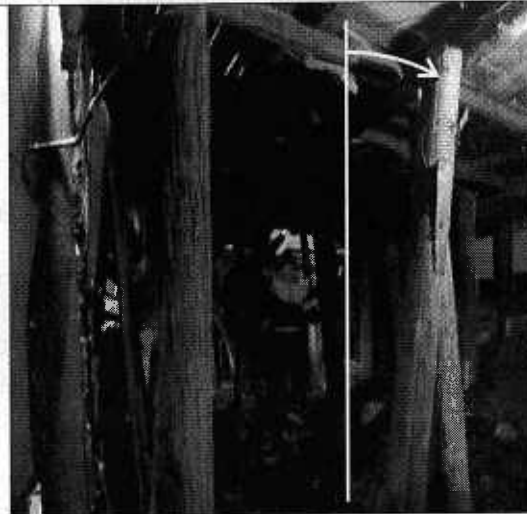
Fotografía 10. Se evidencia un avance significativo respecto a lo evidenciado en el mes de abril de 2010 a nivel de la cimentación de la vivienda en lo relacionado con la pérdida de verticalidad de los elementos de apoyo de la vivienda. Mayo 15 de 2010.
