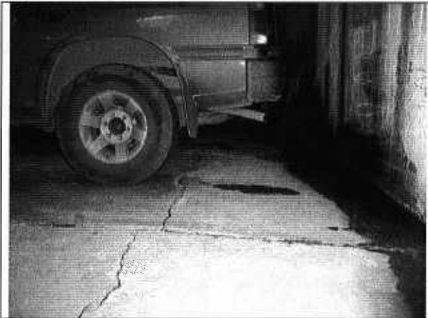
Foto 9. Grieta en la losa de contrapiso del parqueadero, paralela al paramento de los muros de estabilización de los taludes de corte generados durante la excavación para la conformación del sótano.
