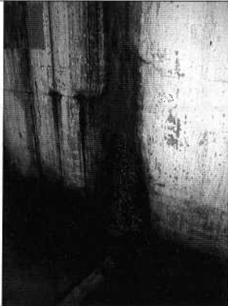
Foto 7. Posibles acumulaciones de óxido producto de la corrosión de las barras de refuerzo de los elementos estructurales del conjunto sótano-losa de parqueadero.
