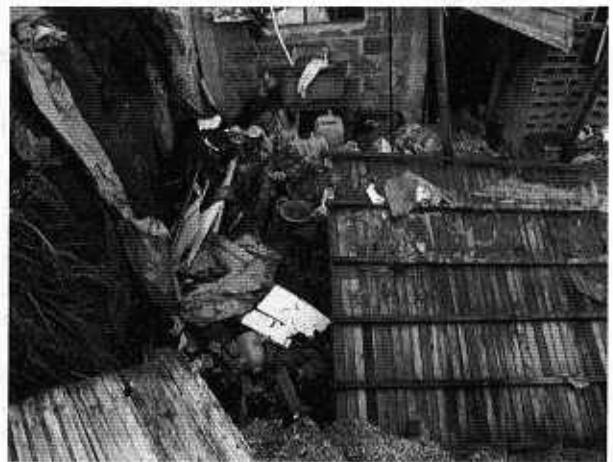
Foto 2. Sector; afectado evidencia del colapso del muro que cumplía la función contención y confinamiento del talud de corte y relleno en el patio de la vivienda
