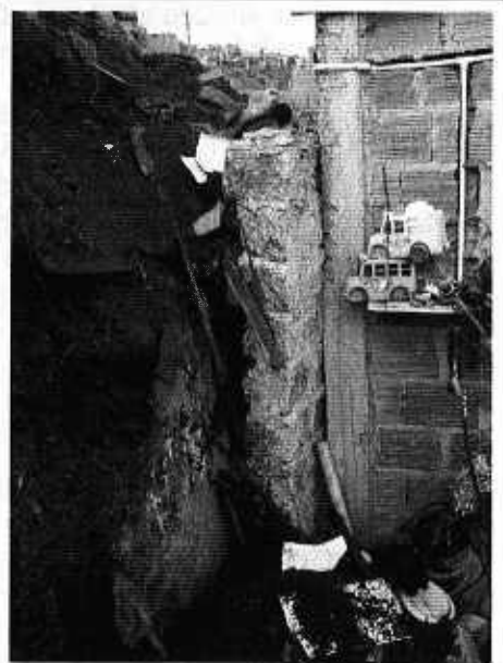
Foto 4. vista del tramo de muro que quedo recostado sobre el muro de cerramiento del costado norte.
