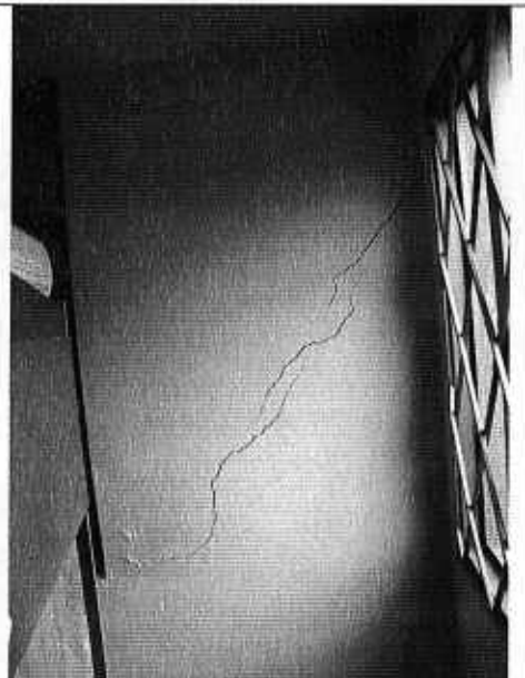
Foto 10. Grietas de tendencia diagonal en muros divisorios del segundo nivel de la vivienda.
