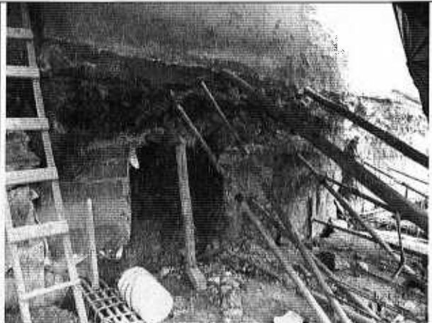
Foto 8. Trabajos de submuración de la cimentación de la vivienda de la Carrera 8 No. 192-42.
