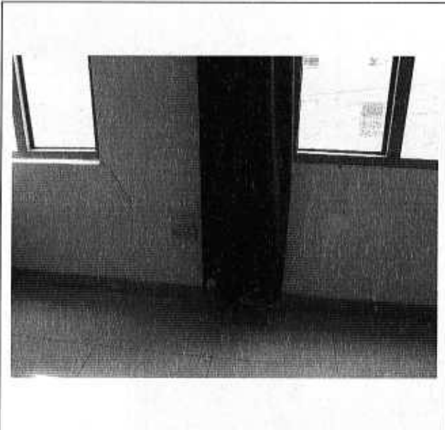
Foto 9. Agrietamientos en muro de antepecho del costado occidental del tercer nivel de la vivienda de la Carrera 8 No. 192-42.
