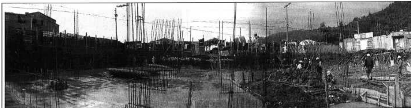
Foto 5. Panorámica del sitio de construcción del proyecto urbanístico Edificio Santa Cecilia. Nótese de la ausencia de medidas competentes de estabilización de los taludes perimetrales de corte generados durante las excavaciones.
