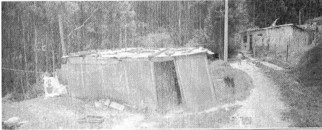
Fotografía 5. Vista hacia el extremo oriental de la Manzana 32. En primer plano se observa el Predio 15, evacuado por pérdida de verticalidad. Al fondo (a la derecha) el Predio 12.
