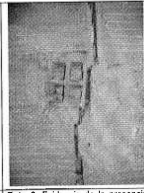
Foto 6. Evidencia de la presencia de grietas al interior de la vivienda de la Carrera 18Q No. 61A-04 Sur, en muros de cerramiento perimetral ubicados al costado oriental de la misma.
