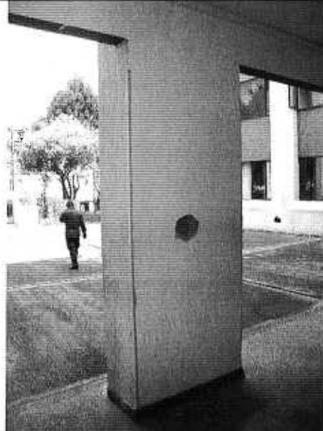
Foto 7. Regata exploratoria que confirma la existencia de columnas falsas (arquitectónicas) en la edificación.
