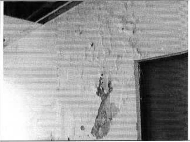
Foto 11. Humedad en la parte media-alta de muros del primer nivel del edificio.
