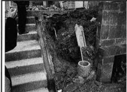
Foto 10. Evidencia de la presencia de flujos de escorrentía sub-superficial en el costado sur-oriental de la vivienda No. 15 de la urbanización "Altos de Galicia".
