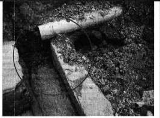
Foto 11. Evidencia de la presencia de flujos de escorrentía sub-superficial en el costado sur-oriental de la vivienda No. 15 de la urbanización "Altos de Galicia".
