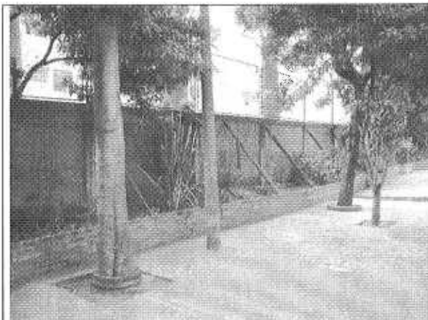
Foto 7. Patio del sector noroccidental del predio, en límites con el Conjunto Residencial Los Pinos. Apréciase la presencia de árboles en el sector adyacente al muro y la matera.
