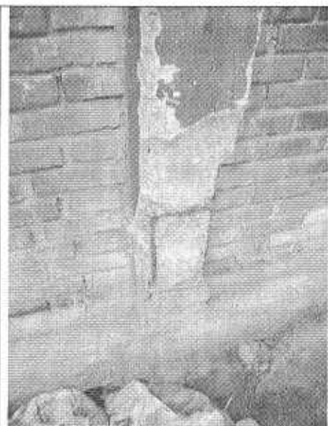
Foto 4. Evidencias de exploraciones de patología en la estructura del aula máxima.
