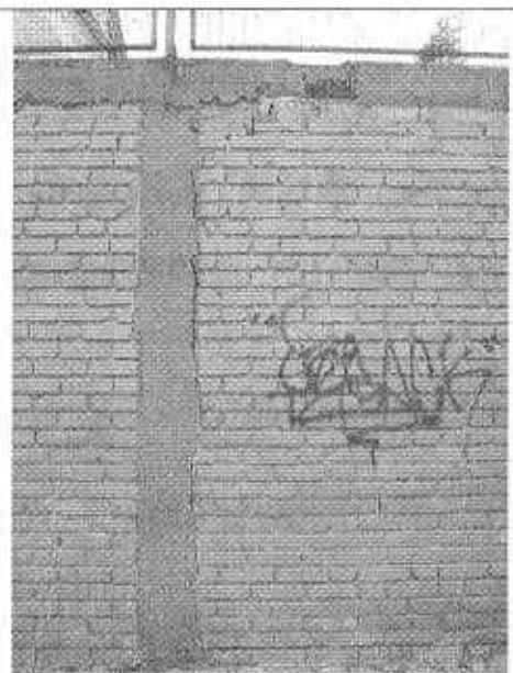
Foto 12. Grieta de tendencia vertical en muro de cerramiento del costado nororiental del Colegio.
