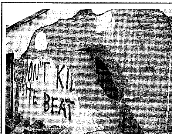
Fotografía 2. condición de deterioro y afectación del muro de fachada frontal de la vivienda afectada ubicada hacia el costado nor occidental del predio de la Carrera 4A # 66 - 03
