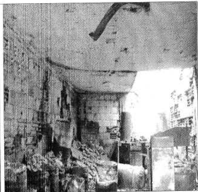
Foto 2. Pandeo evidenciado en la placa de entrepiso del predio de la Calle 76 Sur No. 14B - 68 y afectaciones en los muros de cerramiento de primero y segundo nivel. Agosto 28 de 2010.
