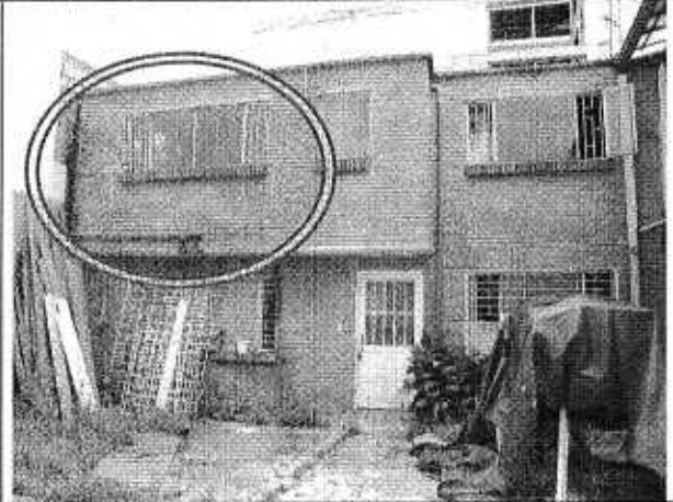
Foto 8. Unidad estructural posterior del predio de la Calle 103A No. 11B-70. En el círculo, el sector de muro inestable.
