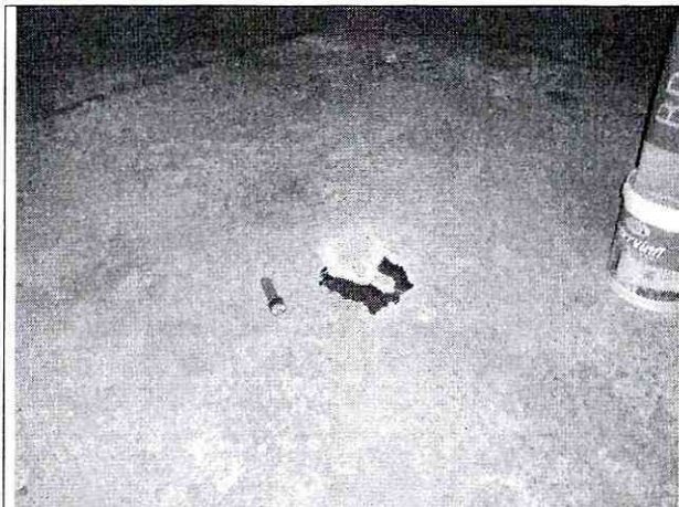
Foto 3. Hueco en la losa de entrepiso que conforma el primer nivel del edificio, zona de parqueaderos. Compárese el tamaño del hueco con el de la linterna ubicada a su lado izquierdo.
