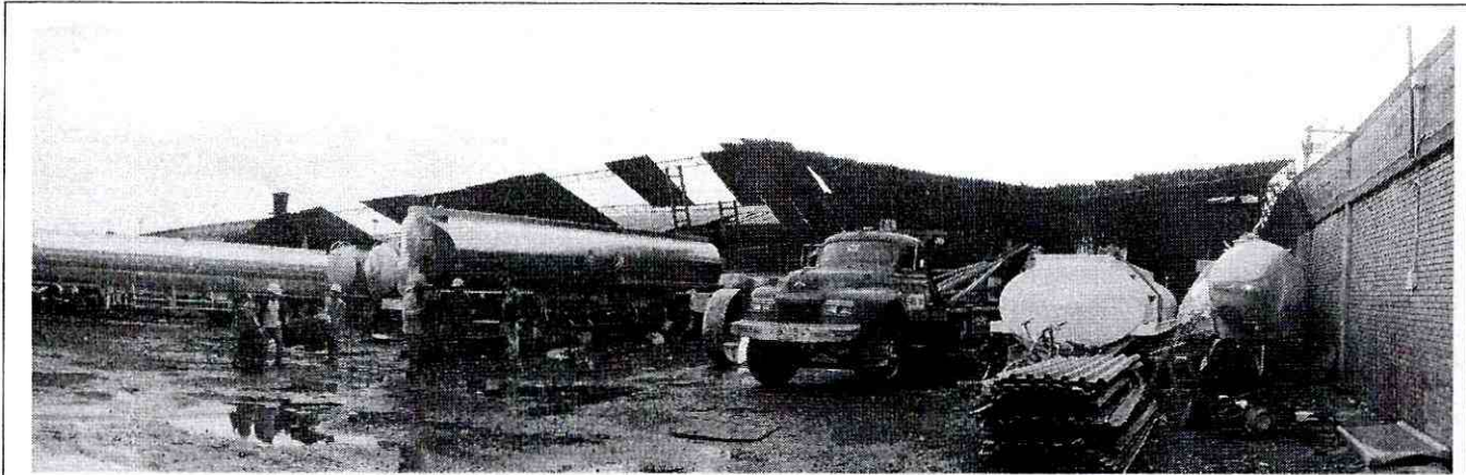
Fotografía 1. Panorámica del costado occidental del predio de la Calle 13 A # 81F-13 evidencia del colapso parcial de la cubierta del mismo costado
