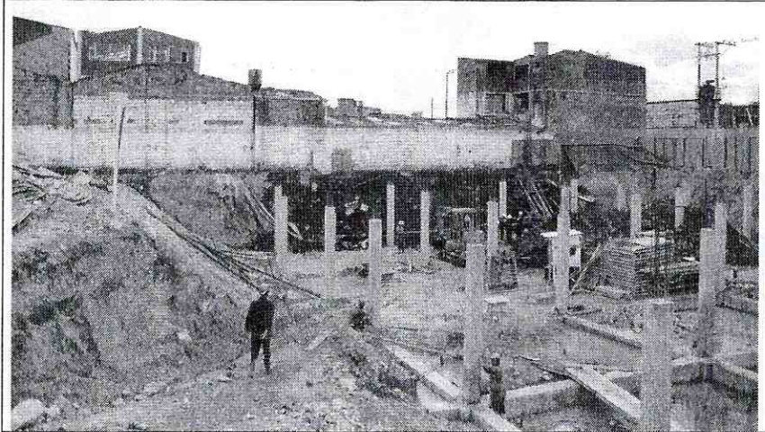
Foto 3. Vista de las obras correspondientes al Templo de la Iglesia de Dios Ministerial de Jesucristo Internacional. En la parte superior de la foto, las instalaciones de la empresa Hilazas Metagam Ltda.
