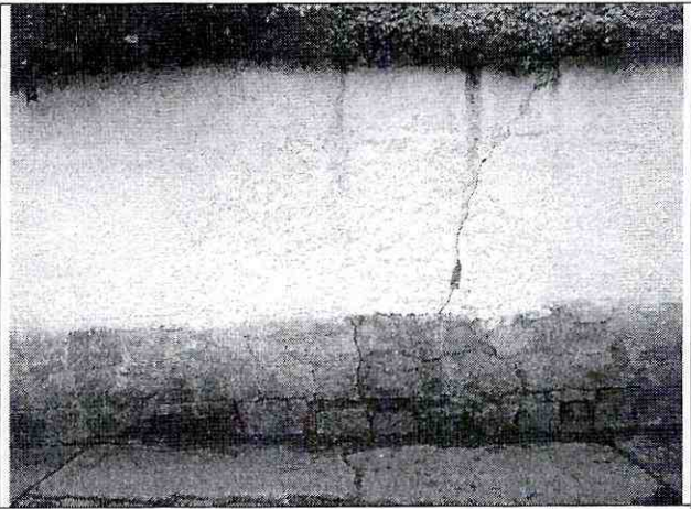
Foto 3. Costado oriental del predio. El muro presenta deformación y agrietamiento de tendencia escalonada.
