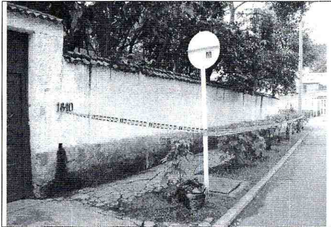
Foto 5. Esquina del muro de cerramiento del predio de la Carrera 18 No. 84-11, en la que se presenta el mayor grado de inclinación.
