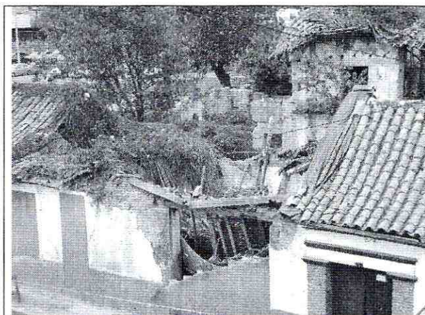
Foto 2. Colapsos de cubierta y daño severo en muros en el predio de la Carrera 7 No. 5-30.
