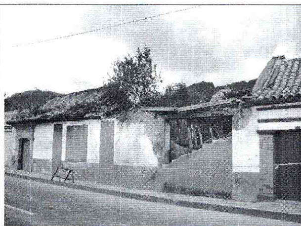
Foto 3. Daño por colapso parcial en el muro de fachada (costado oriental de la Carrera 7) del predio de la Carrera 7 No. 5-30.
