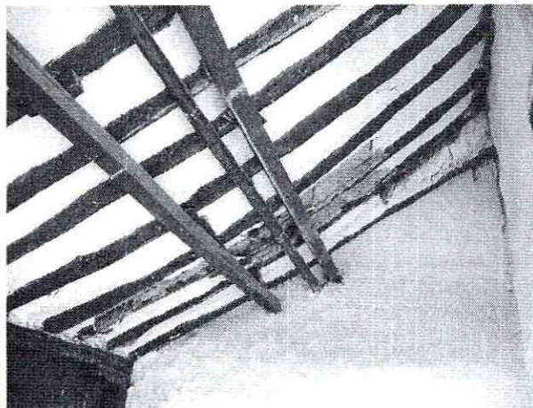
Foto 9. Deterioro severo en acabados de lacara inferior de la cubierta de la Casa Parroquial, Carrera 7 No. 5-26.
