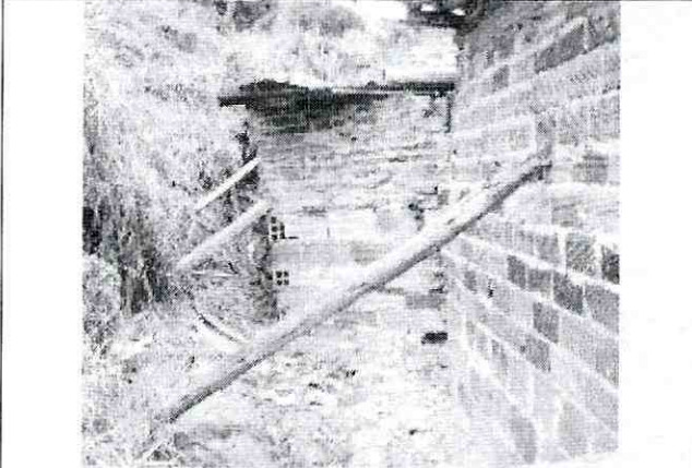
Fotografía No. 2 Vista de los muros perimetrales del costado oriental que presentan agrietamientos y pérdida de verticalidad.
