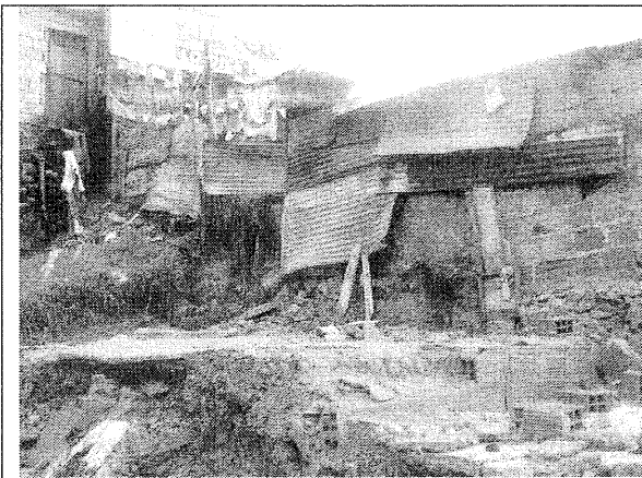
Foto 3. Parte posterior del predio donde se evidencia el desconfinamiento del suelo de cimentación y el colapso parcial del muro de cerramiento del costado sur de la vivienda.
