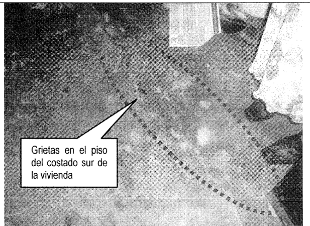
Foto 4. Agrietamiento en el piso del costado sur de la vivienda.
