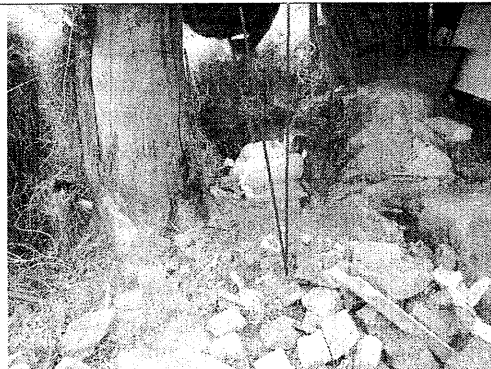
Fotografía No. 3. Evidencia de la inclinación que presenta el tronco del árbol que se encuentra emplazado en la zona del patio del predio evaluado.
