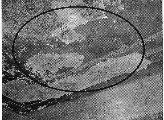
Foto 4. Vista del cielo raso que presenta desprendimientos del mortero, al interior del predio Evaluado Calle 8 Sur # 12-12 Este.
