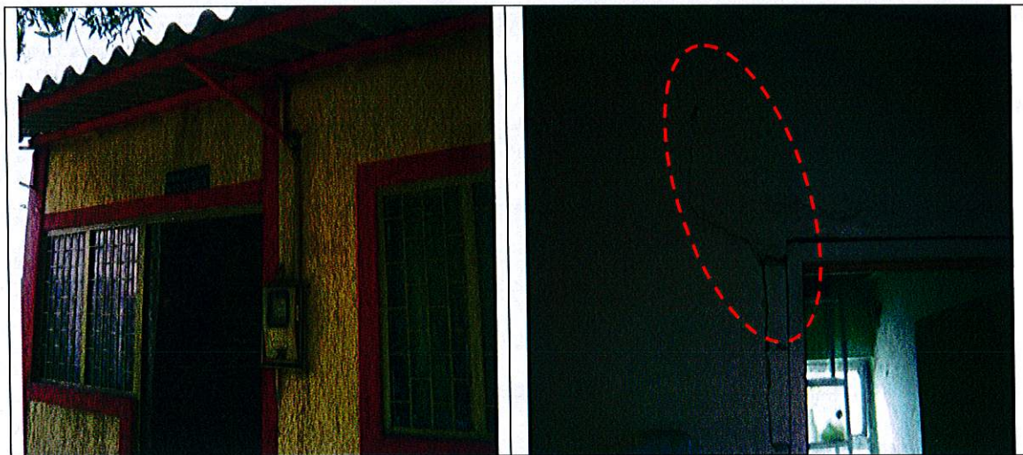
Fotografías No. 35- 36 - Vivienda emplazada en la Manzana 9 Lote6 Diagonal 70A Sur No.1C - 57 Este donde habita el señor Julio Lozada y su familia. La vivienda consta de un nivel construida en mampostería semiconfinada, se observan fisuras de tendencia vertical en los muros divisorios y a nivel de pisos. Los daños evidenciados comprometen la habitabilidad y estabilidad de la vivienda en el corto plazo, se recomienda su evacuación.
