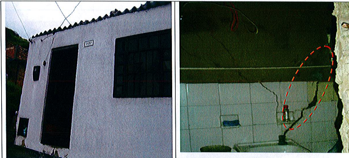
Fotografías No. 11-12.- Vivienda emplazada en la Manzana 18 Lote 7 Diagonal 71C Sur No.1D - 35 Este donde habita la señora Elvia Maria Garcia y su familia. La vivienda consta de dos niveles construidos en mampostería semiconfinada, se observan grietas de tendencia diagonal en los muros de cerramiento de la parte posterior y lateral del predio. Los daños evidenciados comprometen la habitabilidad y estabilidad de la vivienda en el corto plazo, se recomienda su evacuación.
