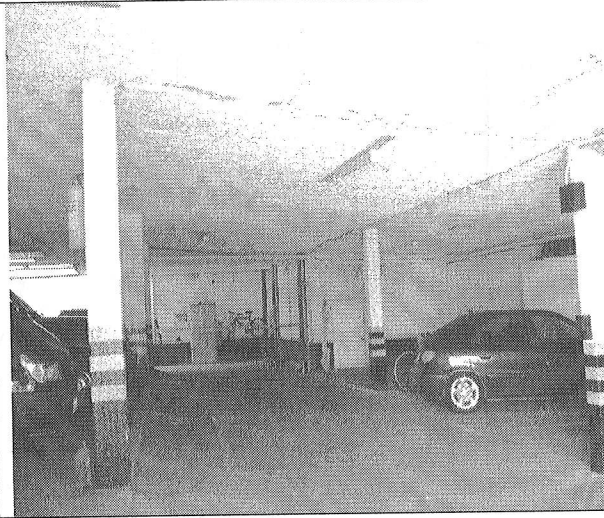
Fotografía 4. Vista de condición de inclinación de las terrazas vistas desde el sótano del bloque oriental.
