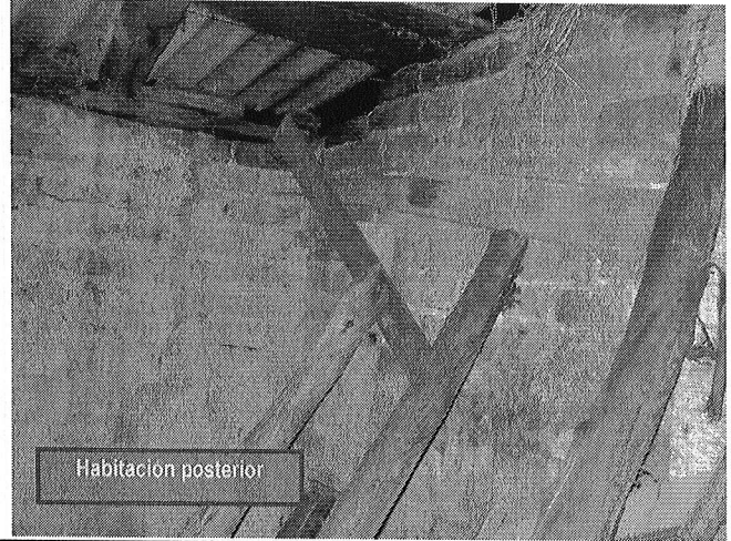
Fotografía 10. Muro de cierre por el costado XXX de la habitación contigua al baño. Los responsables de la misma apuntalaron el muro afectado directamente por la masa deslizada; este muro presenta agrietamientos y deformaciones.
