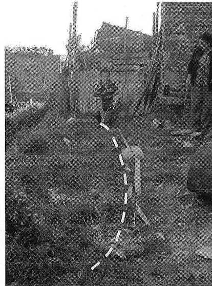
Fotografía 5. La grieta, medida con la varilla de la fotografía anterior, tiene una profundidad de por lo menos 0,5 m.
