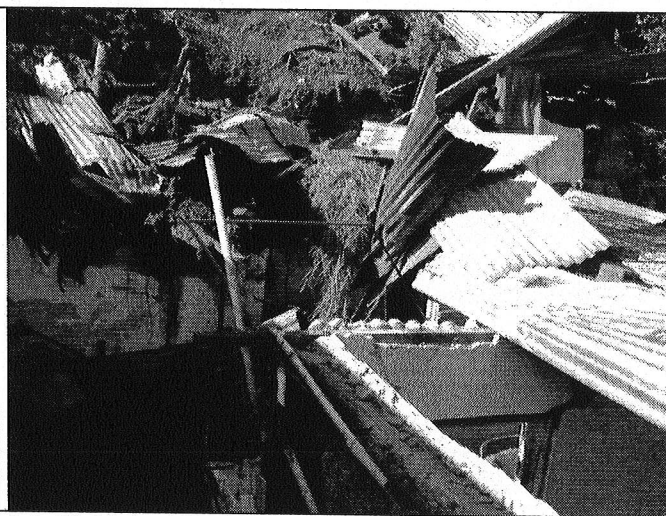
Foto 26. Interior de la vivienda de la Carrera 5A Bis # 51B - 24 Sur en donde se presentó la muerte de una persona.
