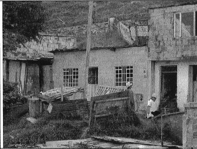
Foto 31. Vivienda de la Carrera 5A Bis # 51B - 06 Sur afectada por colapso parcial de muros del costado sur y de la cubierta
