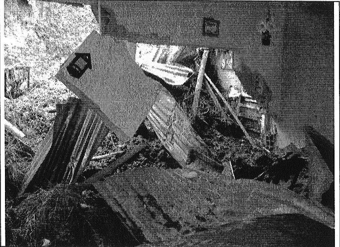
Foto 28. Anegación por lodo y colapso parcial de muro divisorio interior de la vivienda de la Carrera 5A Bis # 51B – 18 Sur, por causa del impacto de la masa desplazada.
