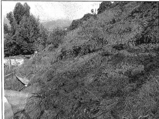
Foto 21. Parte baja del talud. Se observa el alto contenido de humedad del material deslizado.
