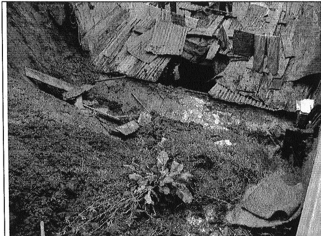
Foto 3. Vista desde la parte alta del talud de corte. Se observa en la parte baja del talud de corte la vivienda emplazada en el predio de la Carrera 5 Este # 49D - 40 Sur.
