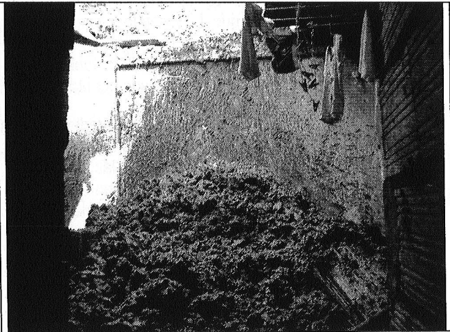
Foto 4. Parte posterior de la vivienda emplazada en el predio de la Carrera 5 Este # 49D - 40 Sur. Se observa el material terreo acumulado en la zona de patio de la vivienda.
