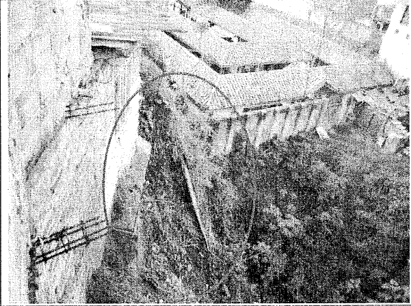
Foto 2. Evidencia del desprendimiento de material proveniente del suelo de cimentación ubicado al costado nor-occidental del predio evaluado.
