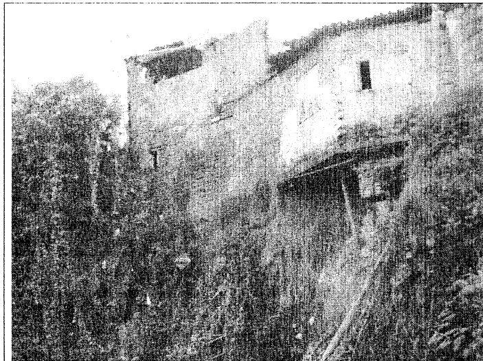
Foto 5. Evidencia de la carencia de una adecuada estructura de cimentación en las estructuras evaluadas, de igual manera la presencia de un puntal en madera en la placa de cimentación de la estructura ubicada al costado occidental del predio evaluado.
