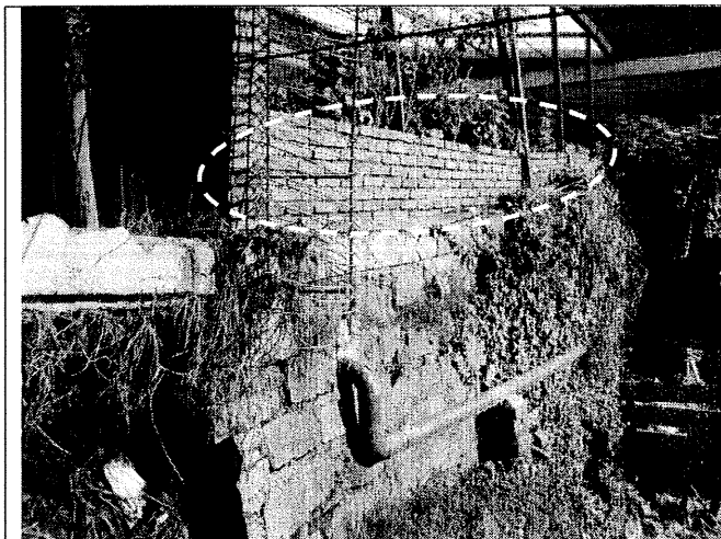
Fotografía No. 4. Se observa el muro de cerramiento en mampostería deformado, el abombamiento del muro de contención en piedra pegada y la afectación sobre la cubierta, con alta posibilidad de colapso, (Tomada el 20 de Abril de 2010).
