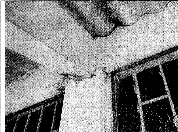
Foto 3. Contacto viga columna en uno de los bloques de salones. Al parecer, la columna fue construida para mitigar daños que se estaban presentando en la edificación.
