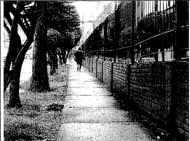
Foto 8. Deformación del cerramiento del conjunto residencial en por hundimiento del terreno en cercanías al árbol de urapán.
