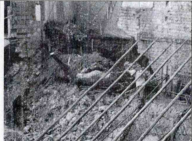
Foto 4. Se observa el colapso parcial del muro de cerramiento del costado norte del predio de la Transversal 19A # 101 – 10, donde se emplaza una edificación de un (1) nivel a cargo de la embajada de Egipto.
