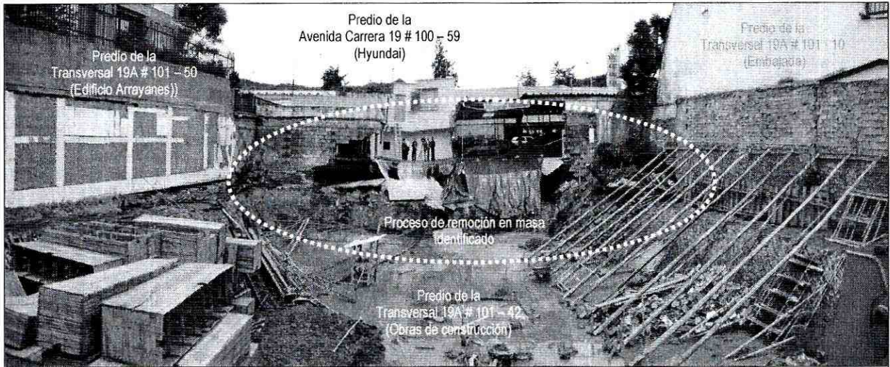
Foto 2. Se observa el proceso de remoción en masa que según lo observado afectó los taludes de corte posiblemente realizados durante las labores de construcción adelantadas en el predio de la Transversal 19A # 101 - 42, por parte de la Constructora "Baluarte Construcciones y Diseños". Se observan los elementos en madera posiblemente dispuestos como medida de estabilización de los muros de cerramiento de la edificación emplazada en el predio de la Transversal 19A # 101 - 10 donde se ubica la embajada de Egipto.
