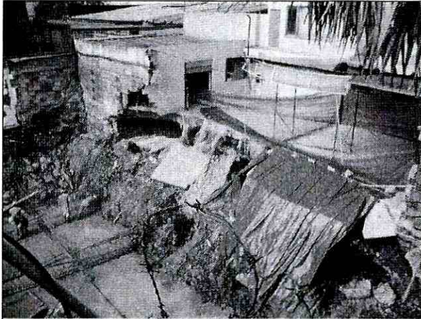
Foto 3. Costado oriental del predio de la Transversal 19A # 101 – 42. Se observan los daños generados en el predio de la Avenida Carrera 19 # 100 – 59, donde se ubica una edificación a cargo de la firma Hyundai.
