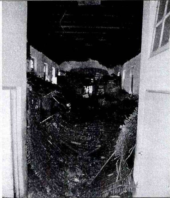
Foto 7. El colapso de algunos sectores de cielorraso, pondría generar la falla de los entrepisos, donde se han depositado los escombros.
