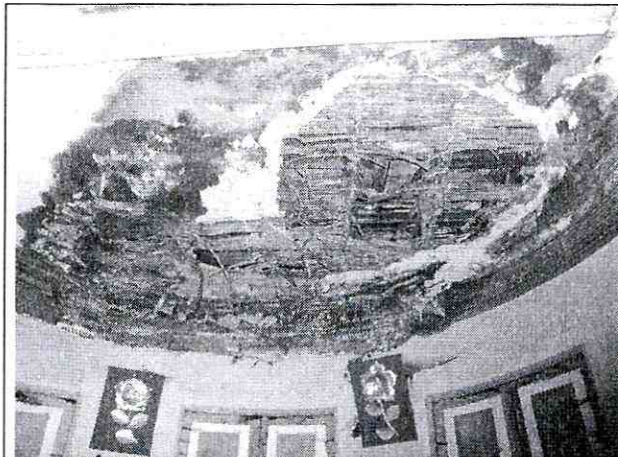
Foto 3. Daño severo del sistema entepiso-cielorraso en la esquina norte de la vivienda.
