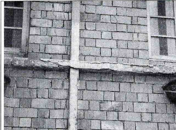
Foto 5. Deterioro, con desprendimiento de fragmentos de mortero, de la cinta en mampostería colocada a la altura del antepecho de las ventanas.
