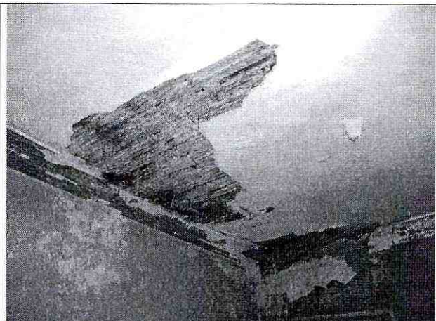
Foto 4. Afectaciones a nivel de cielorraso en la habitación de esquina sur, segundo nivel de la vivienda.
