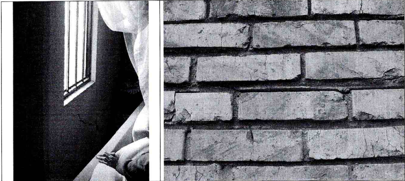
Fotografía 2 y 3. Agrietamiento con abertura máxima de un centímetro, de tendencia diagonal y 1 m de longitud en la parte baja del vano de una ventana, sobre el muro perimetral del costado derecho, Noroccidente, también sobre este muro en la misma zona se identificó una grieta continua de unos 2 m de longitud y tendencia horizontal, cuya abertura se acentúa hacia la ventana descrita anteriormente, hasta alcanzar una abertura de unos cinco milímetros.
