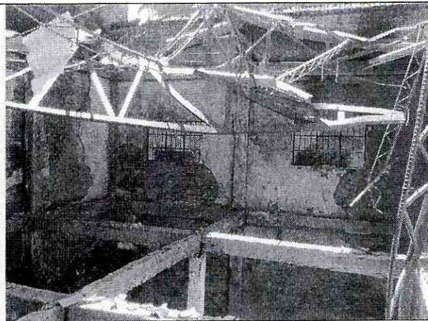
Foto 2. Colapso parcial de la cubierta de la bodega ubicada en la zona posterior del predio de la Calle 10 No. 15-35.
