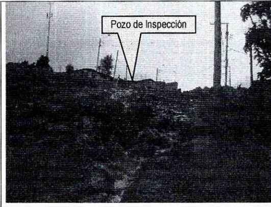
Foto 6. Evidencia de la filtración de aguas negras en la ladera proveniente del pozo de inspección localizado frente a la vivienda de la Transversal 11 Este No. 62 – 92 Sur.
