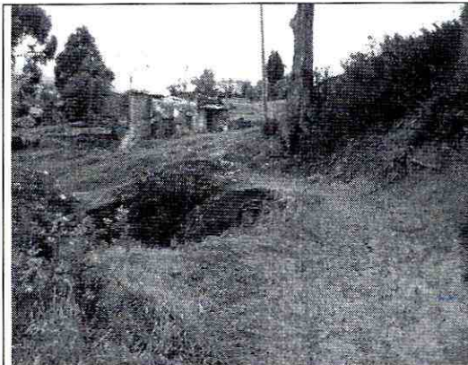
Foto 5. Aspecto del Fenómeno de Remoción en masa sobre la margen izquierda de la Quebrada Verejones, no se evidencia avance significativo en las condiciones respecto a lo evidenciado el día 23 de Febrero de 2010. (Fotografía tomada el 20-02-10).
